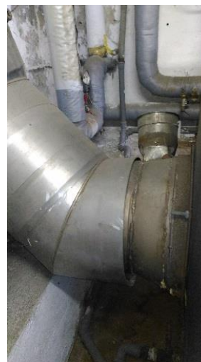
Figura 4.12 - Particolare della caldaia ubicata nell'edificio E1375
